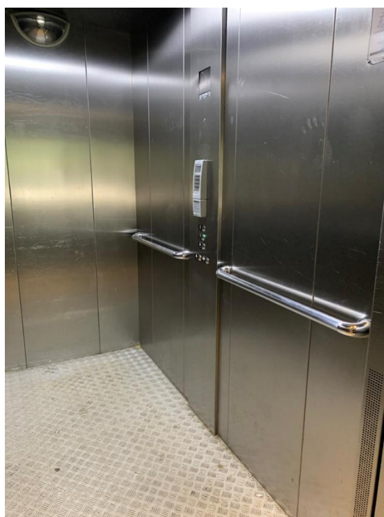
Figur 32. Elevator med greb
